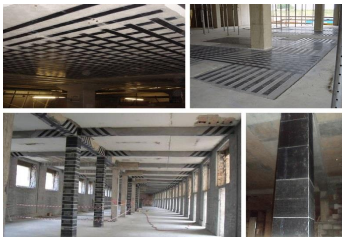
Slika 5.36. Ojačanje ploča, greda i stubova FRP trakama („Cabot Hall“, n.d.; „Column strengthening using carbon fiber“, n.d.; Imperatore et al., 2012; „Seismic retrofiting“, n.d.)
