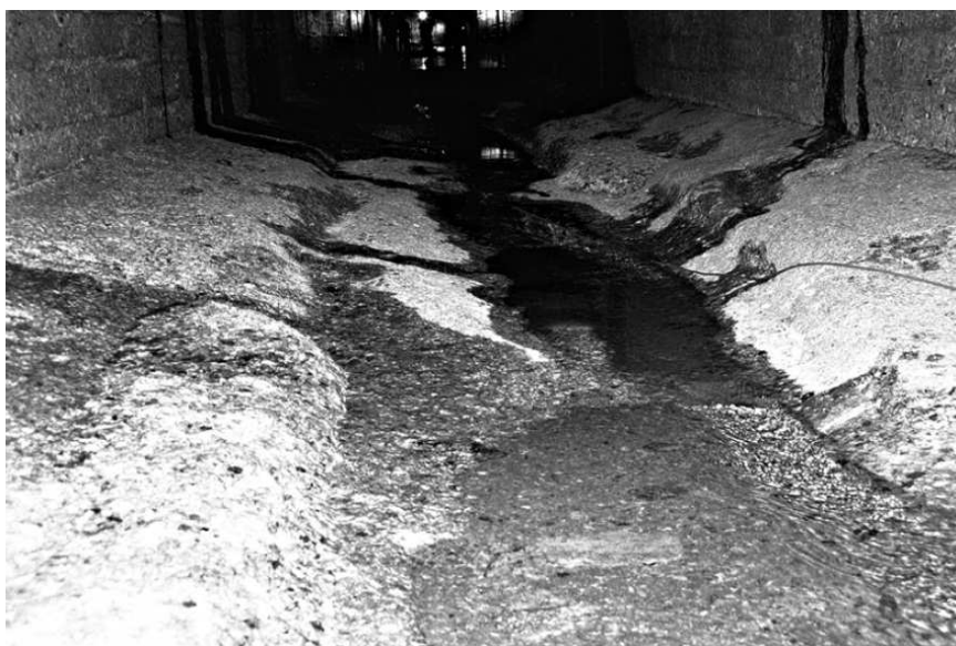
Slika 8.2.7. Abrazivno oštećenje betonskog dna tunela za pražnjenje akumulacije [11]
