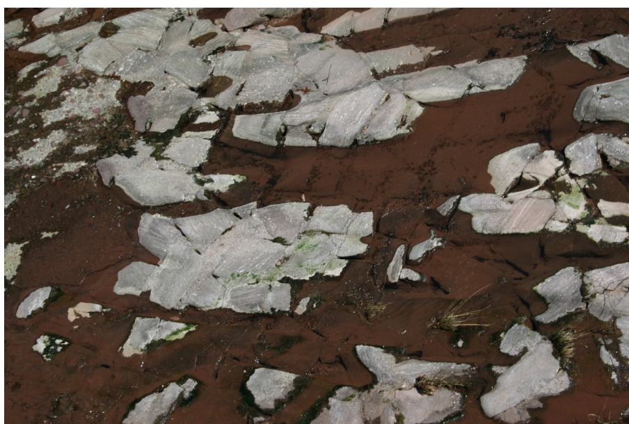
Slika 8.2.4. Uticaj abrazije na strukturu betona brzotoka kanala za ispiranje nanosa na zahvatu HE „Temac“
