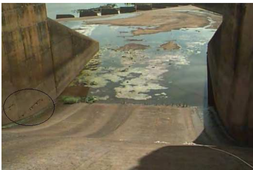
Slika 8.2.8. Oštećenje prelivne brane usled abrazije [253]
