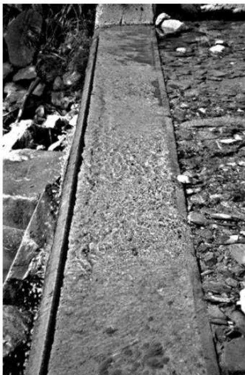
Slika 8.2.5. Hidro-abrazivno oštećenje betonskog praga nastalo u koritu planinskog brzaka [11]
