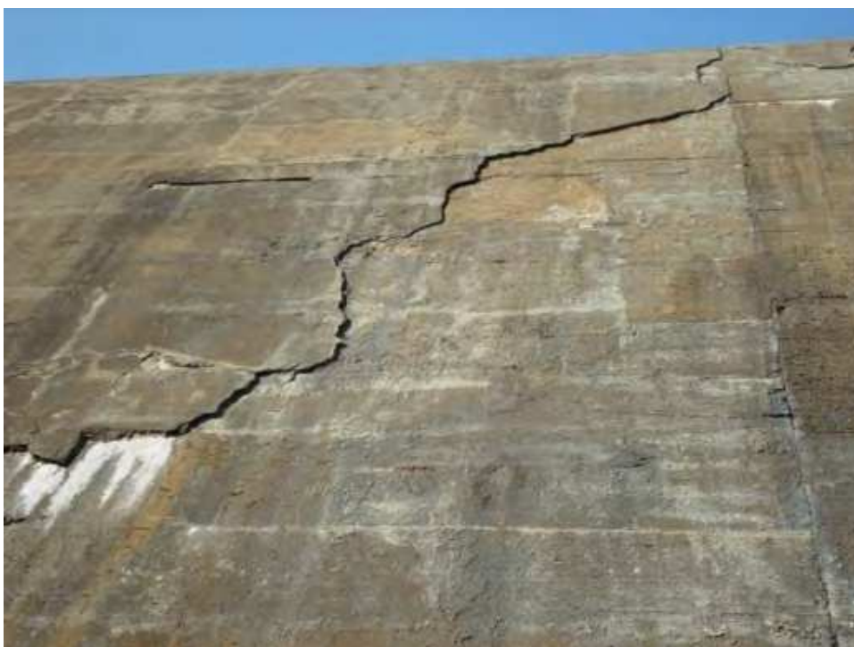
Slika 8.2.10. Pogled na prelivnu branu (slika gore) i detalj deterioracije betona prouzrokovanog hidro-abrazivnim procesom (slika dole) [253]
