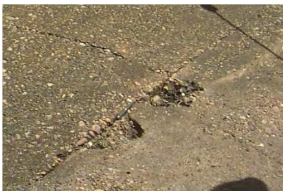
Slika 8.2.9. Defekti na betonskoj konstrukciji uzrokovani abrazivnim procesom [253]
