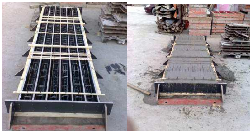
Слика 6-4: Калуп са арматуром и постављеним дистанцерима пред уградњу бетона и изглед греда у калупу после уградње бетона
