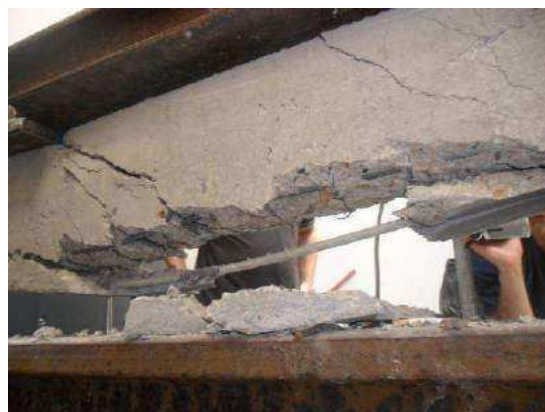
Слика 6-84: Одвајање бетона у висини заштитног слоја бетона (задња страна носача)
