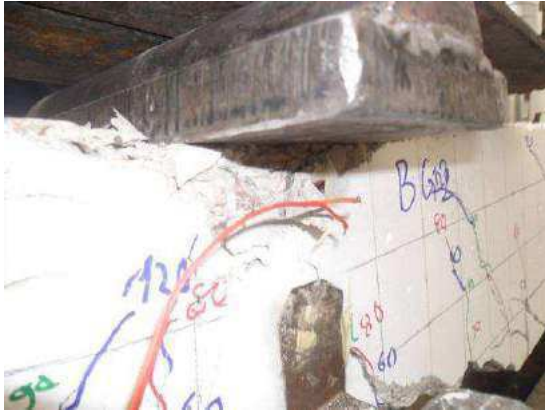
Слика 6-79: Мрвљење бетона у зони аплицирања силе
