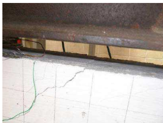
Слика 6-88: Прсине у бетону које просецају прорез са ојачањем и епоксидном исуном на горњој страни носача
