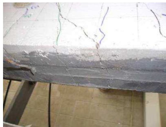
Слика 6-93: Пррине у бетону које пресецају прорез са ојачањем и епоксидном испуном са доње стране носача
