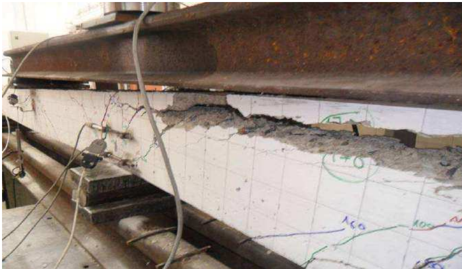
Слика 6-89: Лом гредног носача Б-Ц1 настао губитком приањања ЦФРП арматуре
