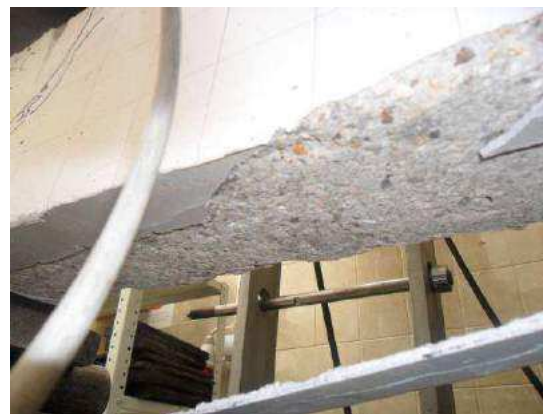
Слика 6-95: Губитак везе на споју бетона и епоксидног лепка на доњој страни носача
